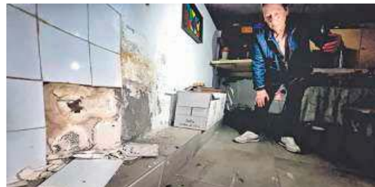
Filtraciones de agua en el trastero de una vecina por un socavón
